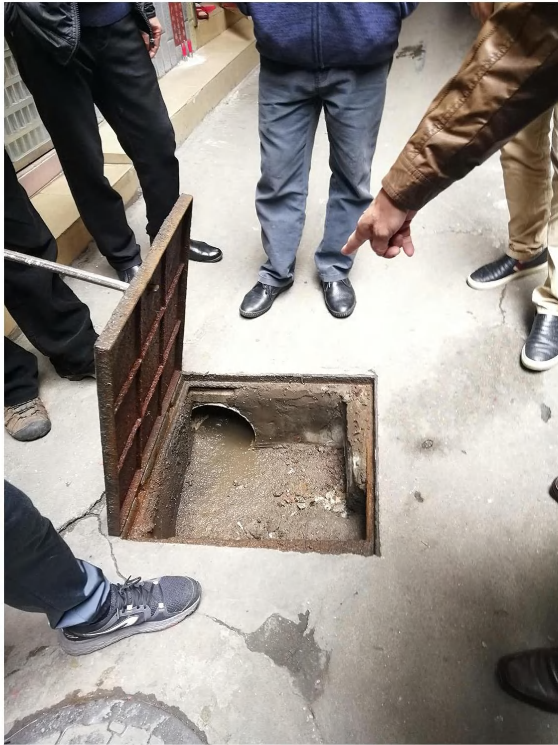
管道老化堵塞严重
