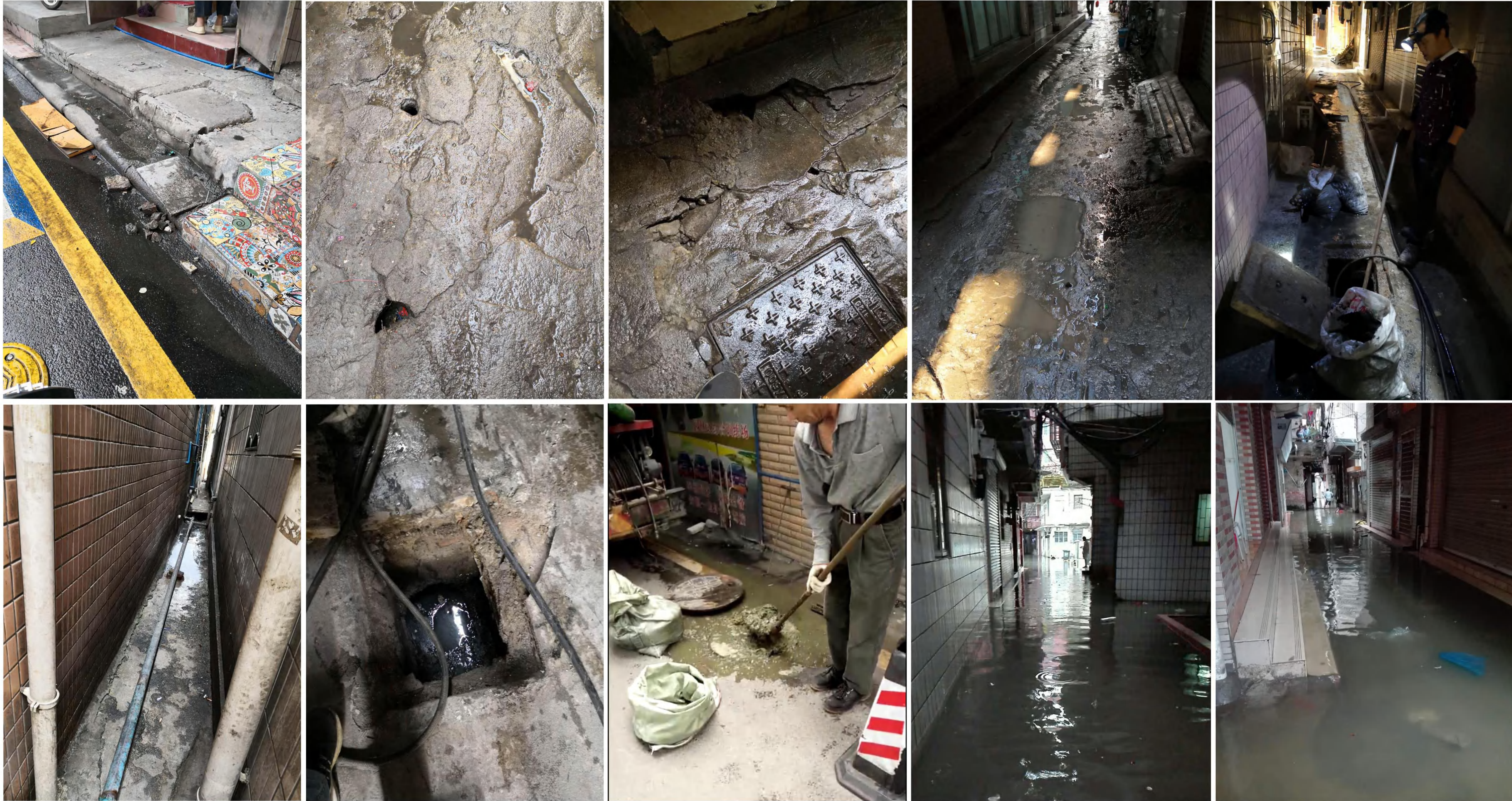
④、旧居民区排水管道严重老化、堵塞， 雨季内涝，水淹情况时有发生 ，造成管理成本持续升高，虽村集体已采取措施反复清理疏通，但收效甚微，该情况对居民财产、人身安全形成 较大安全隐患 。
